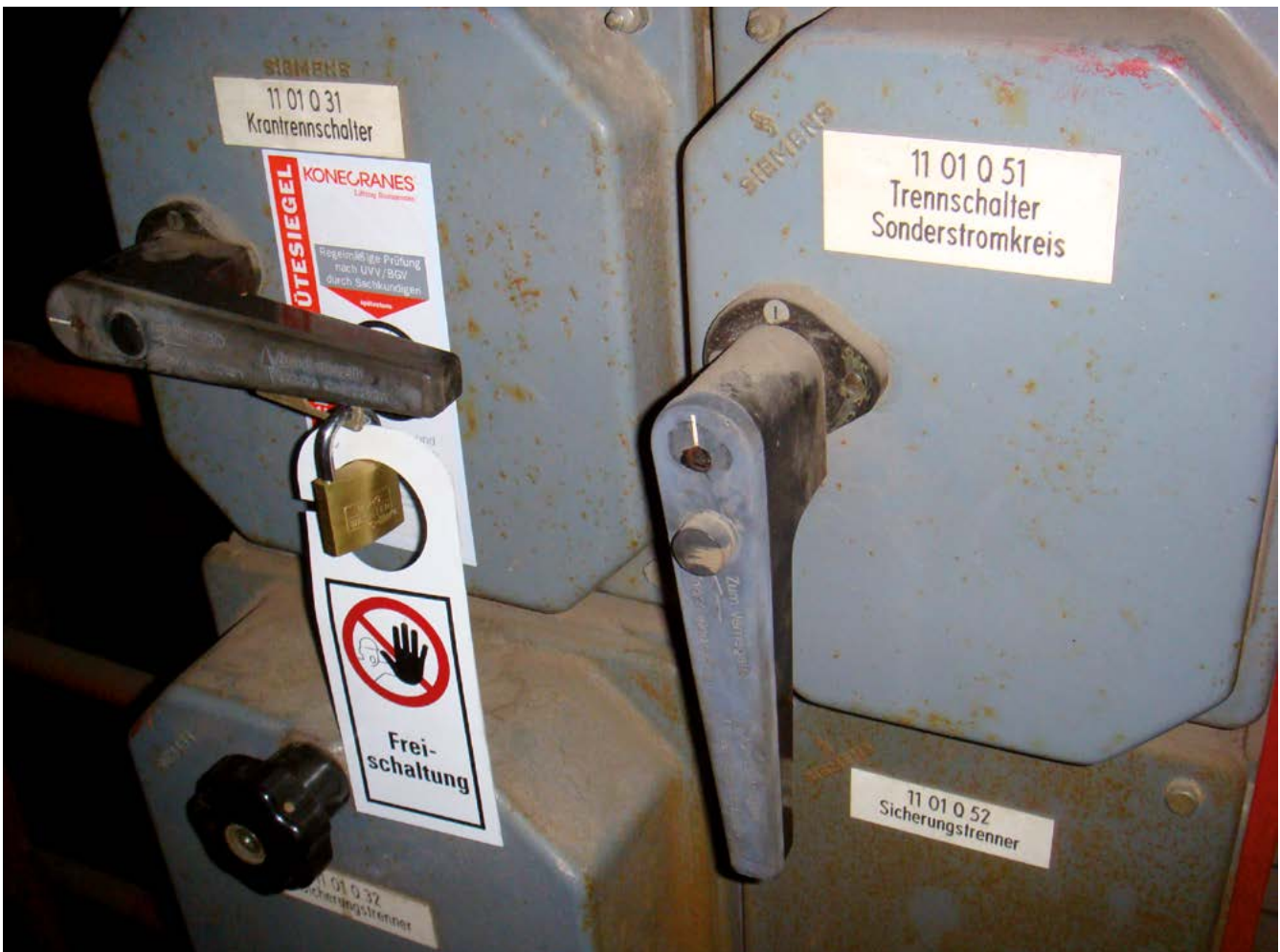
Bild 8-1: Der Krantrennschalter ist ausgeschaltet und durch ein Vorhängeschloss gegen das irrtümliche oder unbefugte Einschalten gesichert
