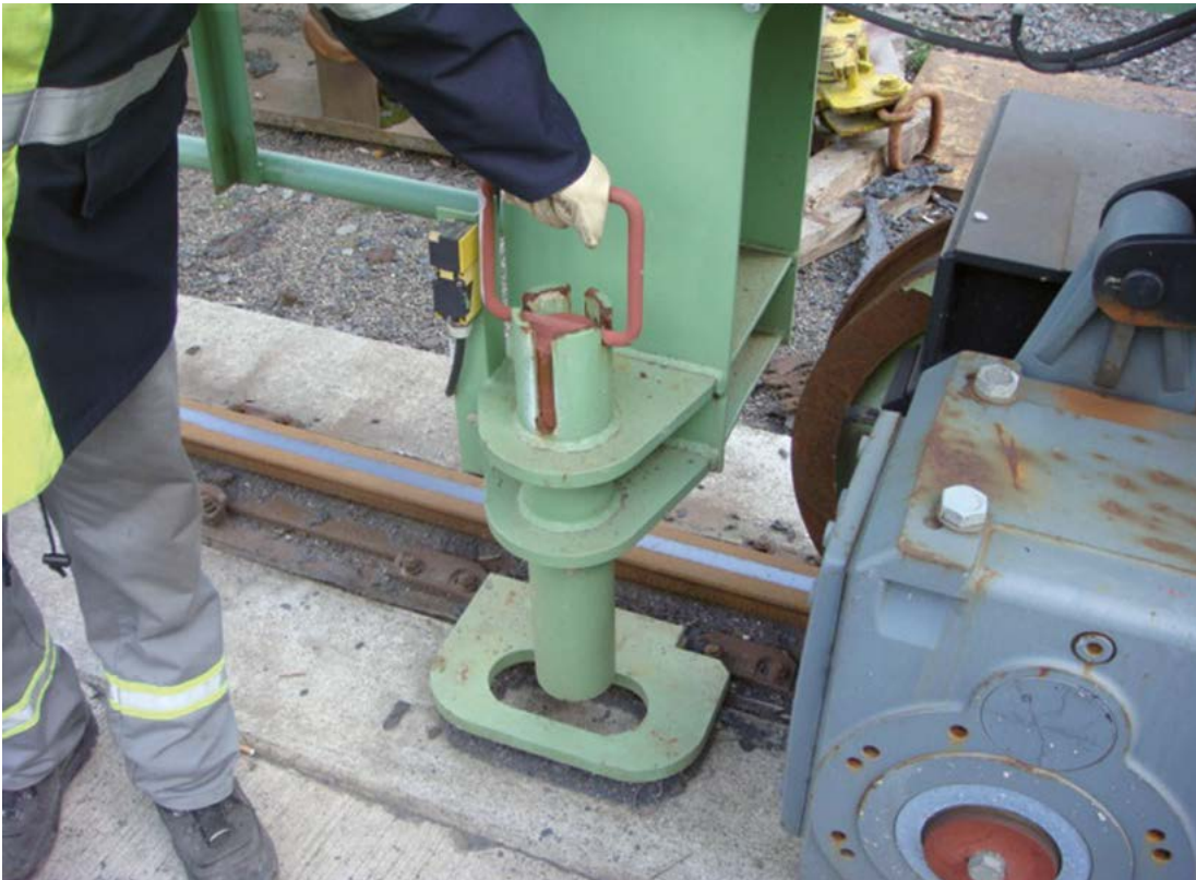
Bild 7-4: Der Portal- kran kann an ver- schiedenen Stellen durch verbolzen gegen abtreiben durch Wind gesichert werden
