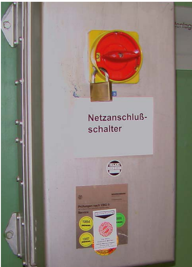
Bild 7-2: Der Kranführer schaltet den Netzanschlussschalter aus
